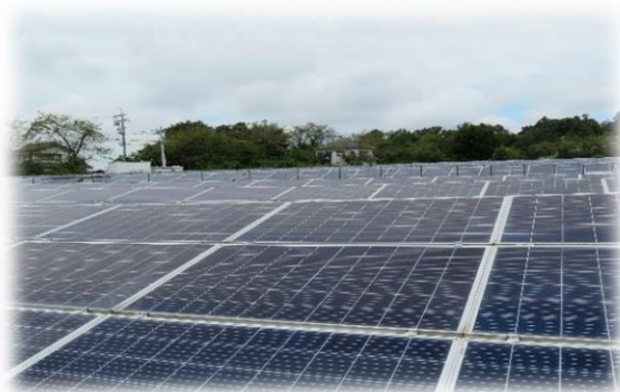
太陽光発電所
