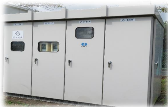
キュービクル式受変電設備
