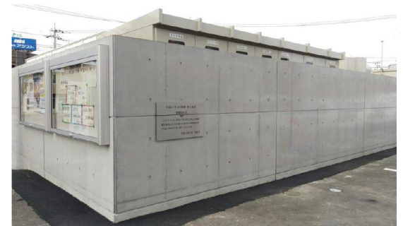
<塀で囲われた電気設備 ※>
