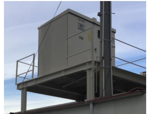
<屋根に設置された架台上キュービクル>
